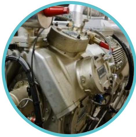
Varmepumpe som primær varmekilde
